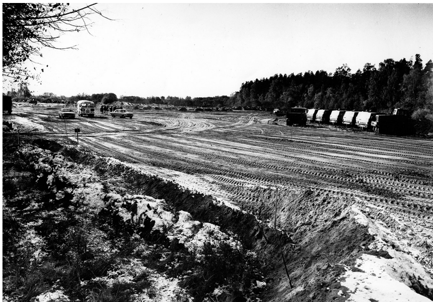
2. attēls. Robežkontroles punkta “Meitene” celtniecība. Fotografējis Valdis Alberts. 1992. gada 13. oktobris. Avots: Latvijas Kara muzejs, krājuma Nr. LKM 6-61731-2812-FT
